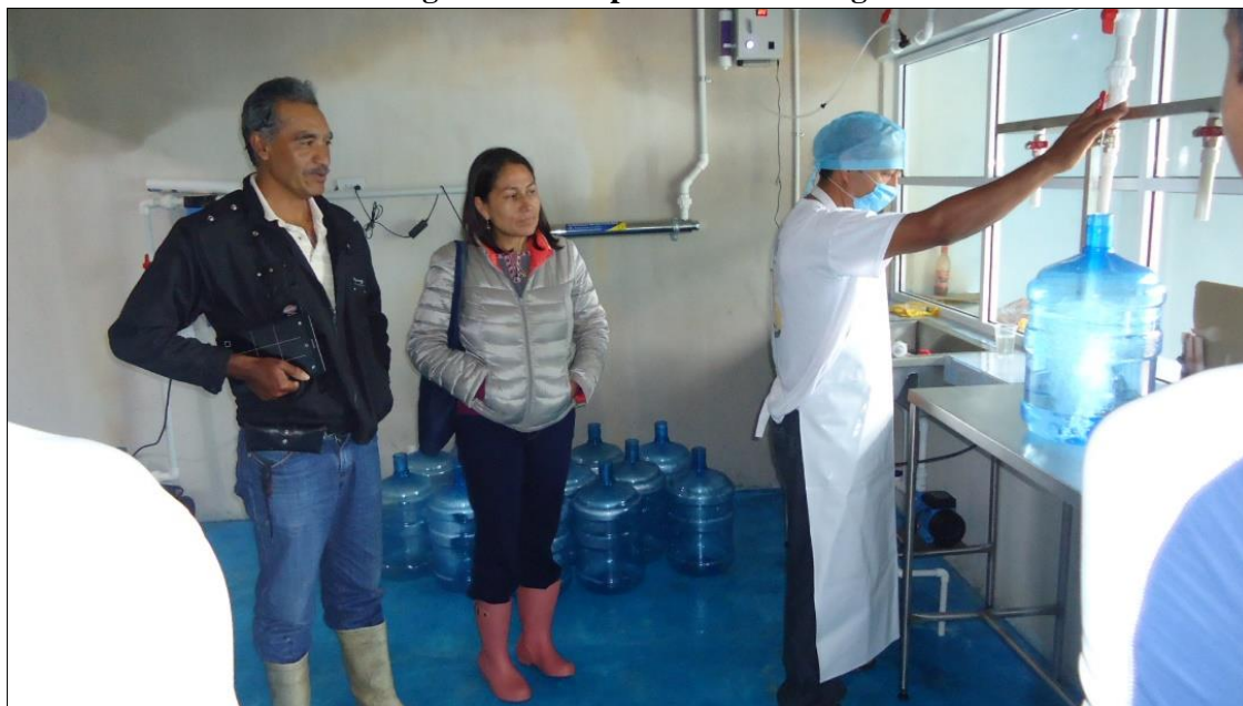
Imagen 3. Planta purificadora de agua
